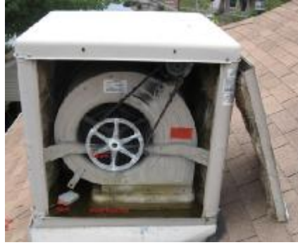
الشكل 9-1/3: مبردة الهواء
