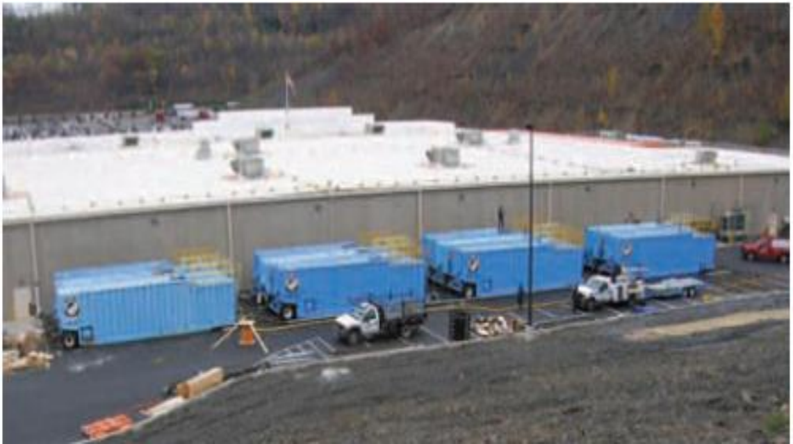
الشكل 7-10/2: خزانات متنقلة لحماية منشأة صناعية عند تعطل مصدر الماء الاساس لنظام إطفاء الحريق [9]
