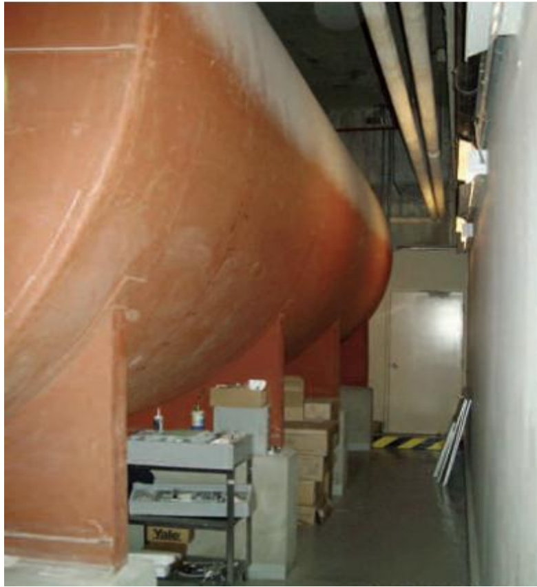
الشكل 7-10/3: خزان فولادي ملحوم في اعلى طابق في مبنى شاهق [9]
