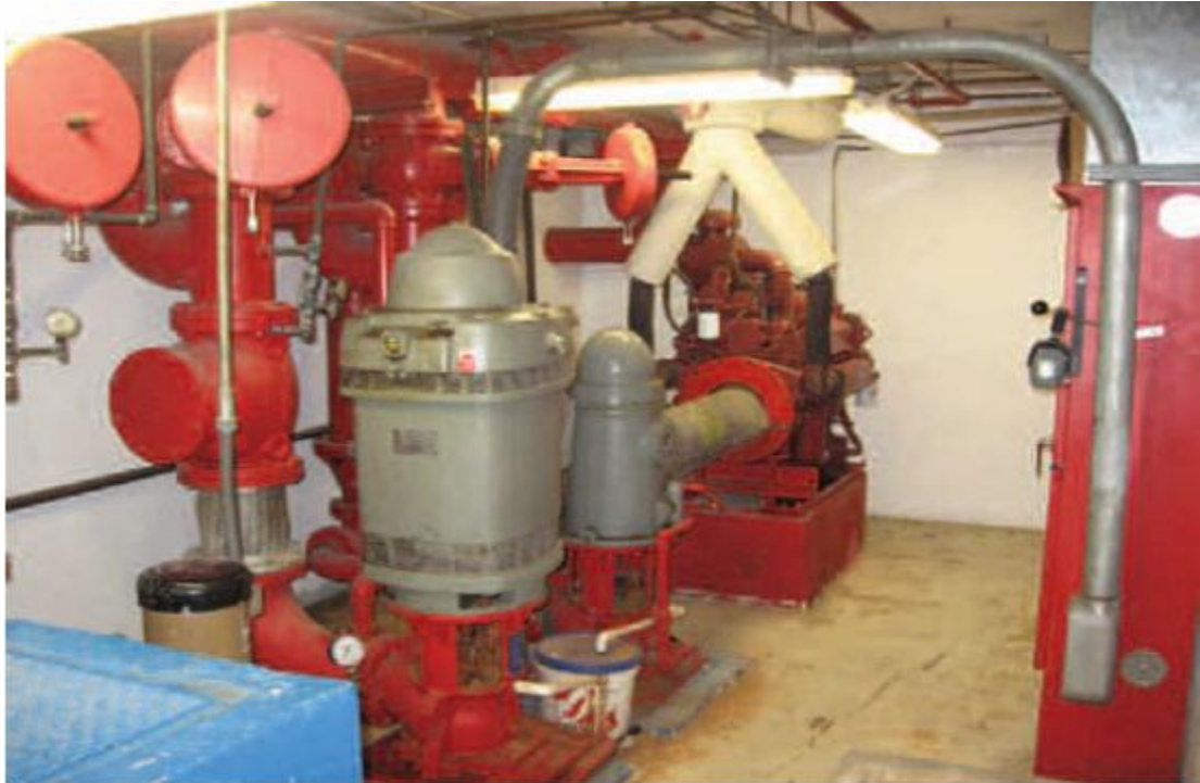
الشكل 7-10/4: مضخات إطفاء حريق فوق سقف خزان خرساني يقع تحت مستوى الارضية [9]
